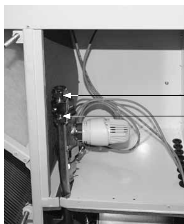
Menovesi 3/8" sisä Paluuvesi Ø 15
